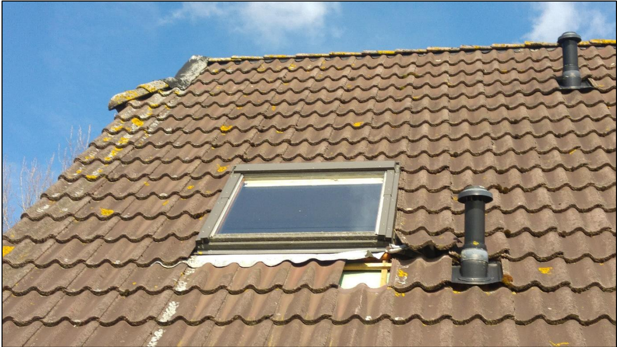
Figuur 3.3. Ontbrekende en losliggende dakpannen die vleermuizen in potentie toegang verschaffen tot de dakconstructie.
