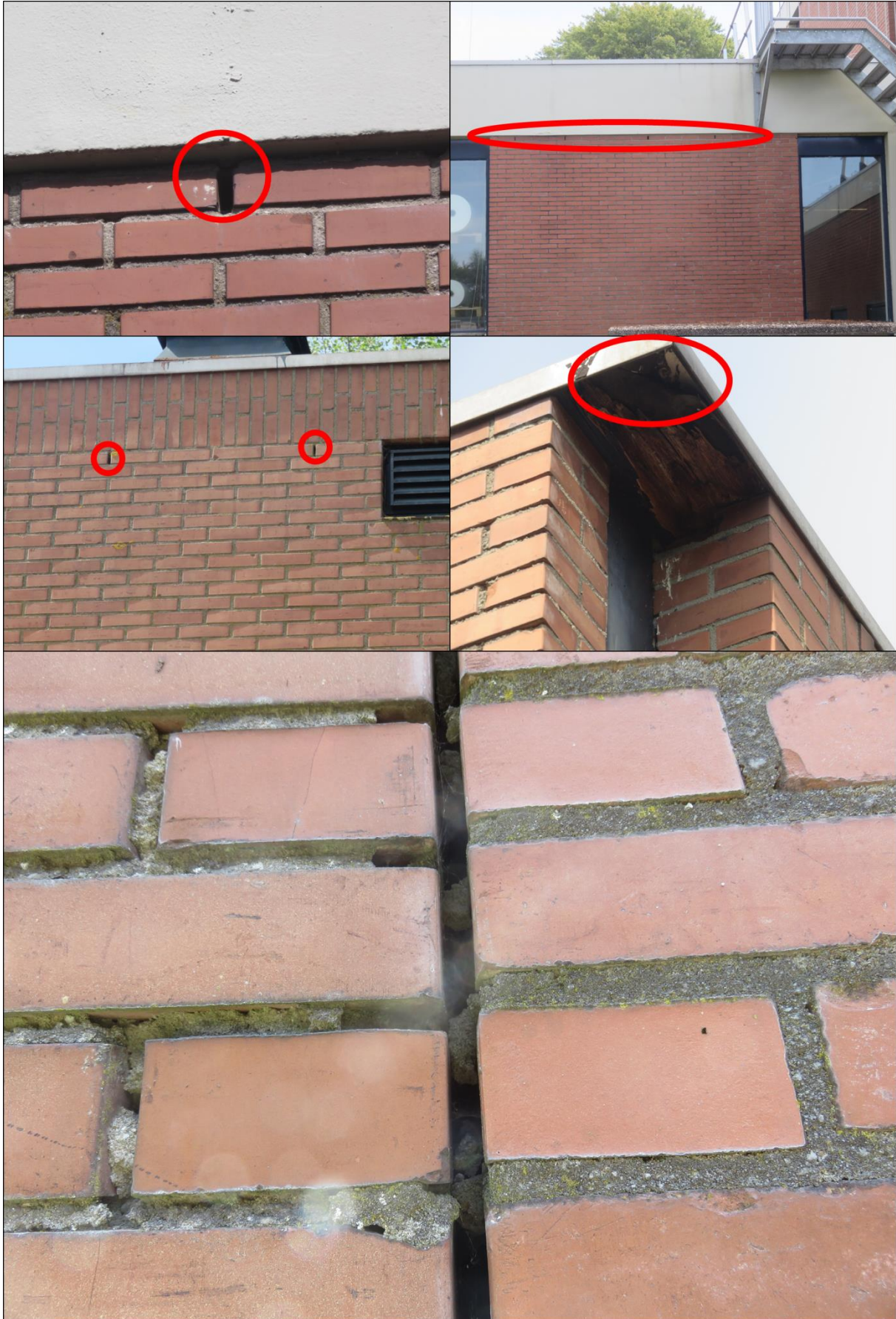
Figuur 2.4. Stootvoegen aan de zuidoost en noordwestzijde van het kantoor- en productiegebouw (boven), stootvoegen in de muur van het chemiegebouw en een gat in de betimmering van de daklaag van dit gebouw (midden) en gaten in het metselwerk van het opslaggebouw (onder).
