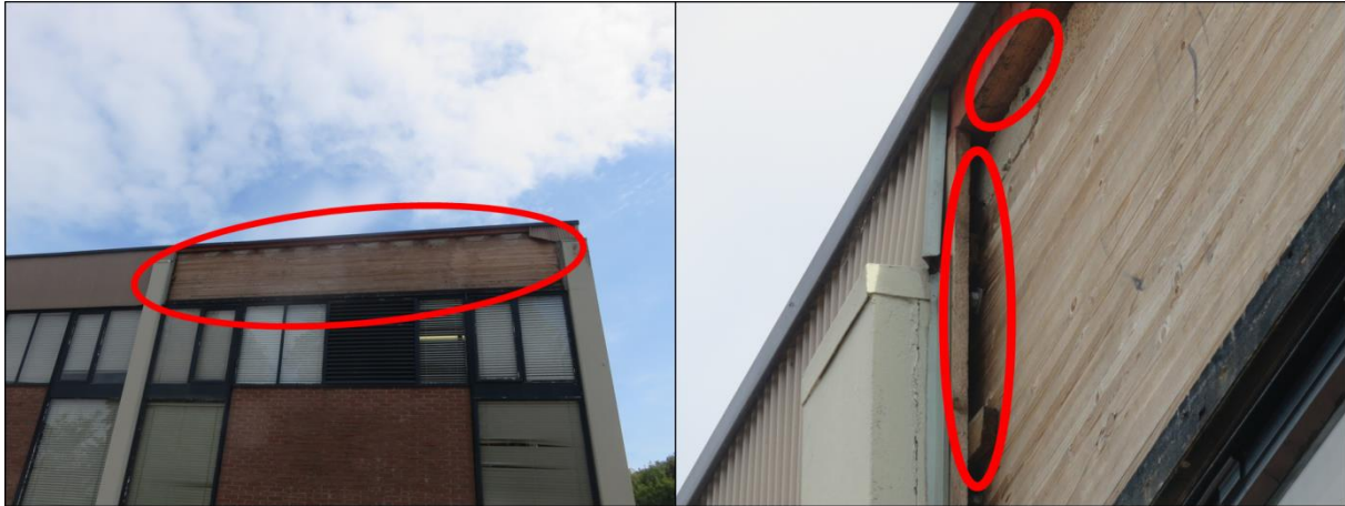
Figuur 2.5. Afgebroken beplating onder de daklijst van het kantoor- en productiepand (links) en toegangen tot potentiële verblijfplaatsen voor vleermuizen in de betimmering van het gebouw. (rechts)
