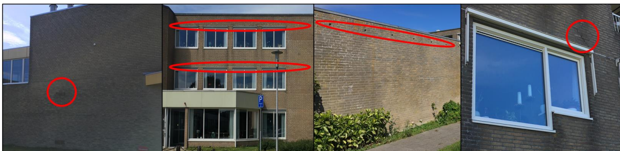
Figuur 2.2. Mogelijke (toegang tot) verblijfplaatsen voor vleermuizen middels stootvoegen/ scheuren.
