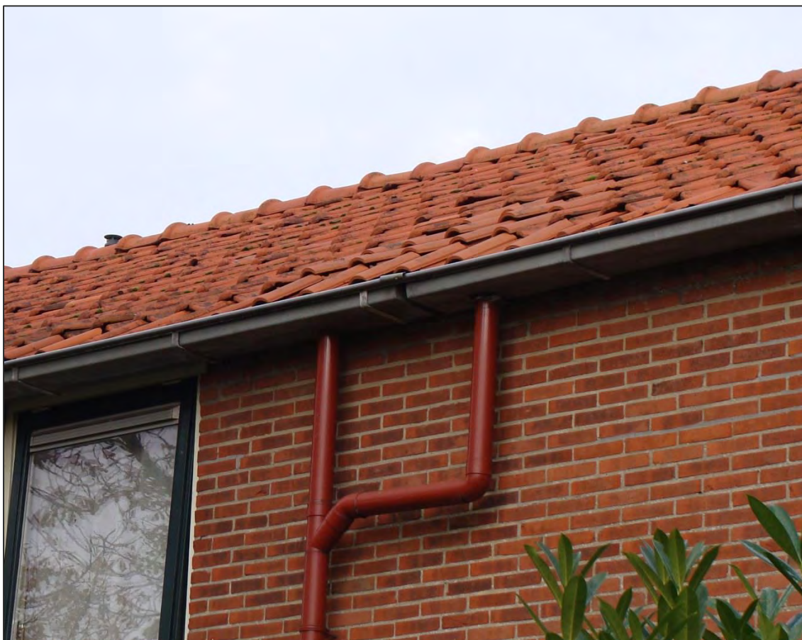
Figuur 7. Lokaal zijn dakpannen opgewipt of beschadigd, waardoor gierzwaluw toegang heeft tot de daken van de rijtjeswoningen.
