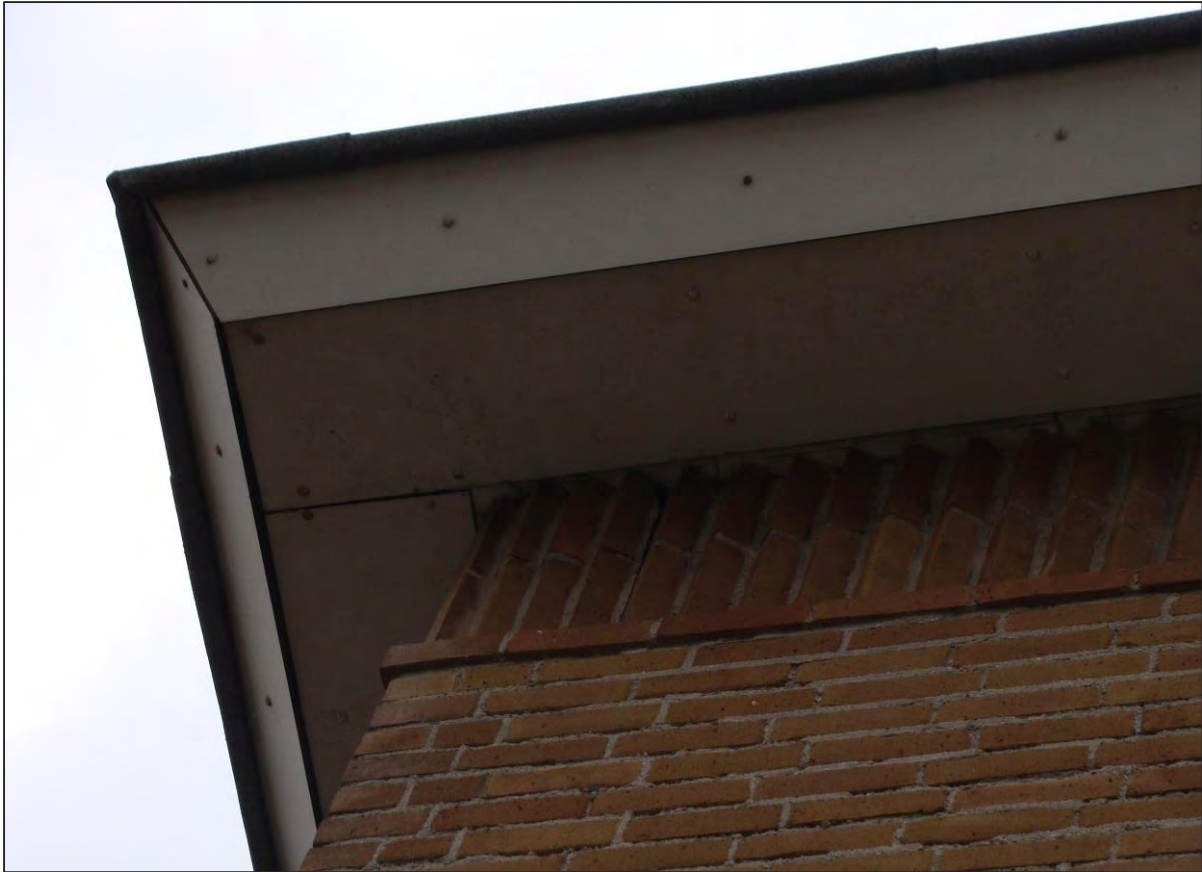
Figuur 13. De geribbelde stenen onderlangs het dak van het centrale gebouw hebben lokaal beschadigingen, waardoor kleinere vlermuizen mogelijk toegang hebben tot de muurdelen of delen van de dakconstructie.
