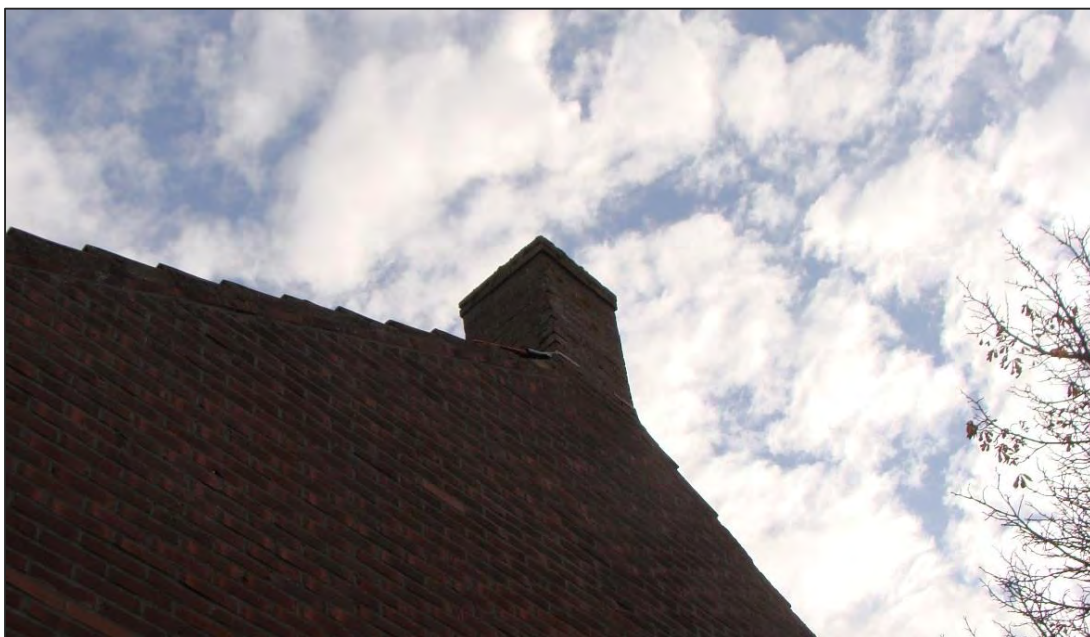
Figuur 12. Bij sommige huizen zijn er op de overgang van gevel naar dak beschadigingen aanwezig, waardoor vleermuizen toegang hebben tot de daken en mogelijk ook de spouwmuur.
