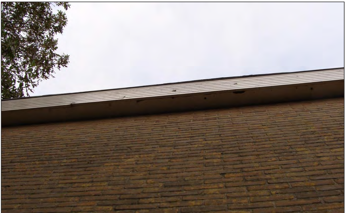
Figuur 14. Beschadigingen aan de dakconstructie van de gymzaal.
