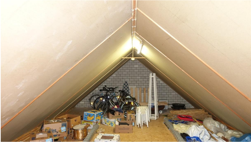
Foto 7. Blik over de zolderverdieping van het hoofdgebouw. De kap is toegankelijk maar niet voor gasten en dient als opslagruimte. De dakplaten zijn overal sluitend waardoor er geen toegang is voor dieren. Foto Johan Krol. 24-11-2021.
