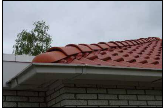
Afbeelding 3.2. Ongeschikt nieuw dak.
