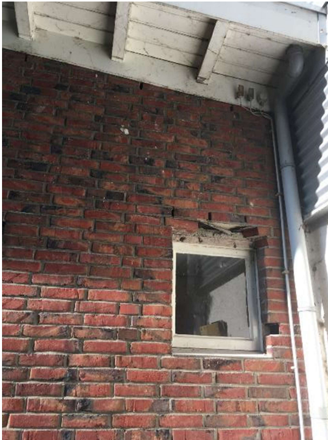
Afbeelding 3.2: open stootvoegen bovenin gevel en boven kozijn, tevens openingen in gevel t.g.v. asbestonderzoek.
