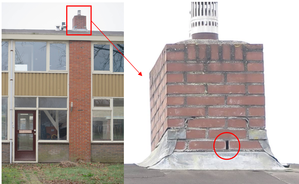
Figuur 4. Potentiele verblijfplaatsen van vleermuizen in de te slopen woningen aan de Halbertsmastraat te Buitenpost.
