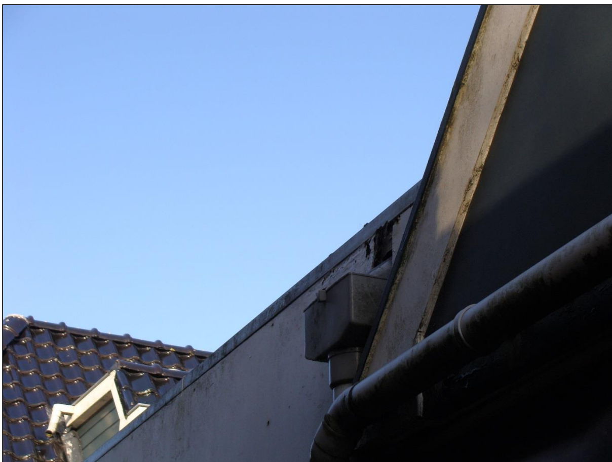
Figuur 16. Aantasting van de witte houten dakrand van de voormalig COOP.
