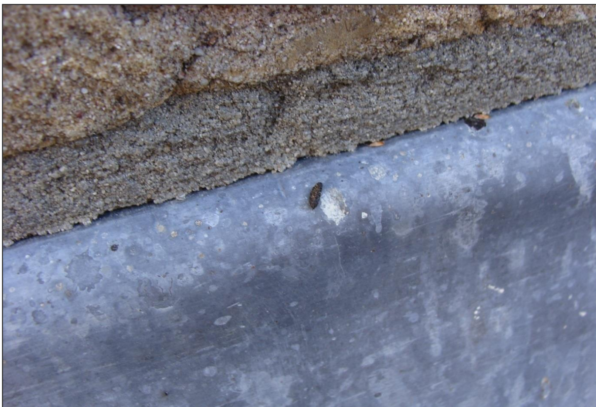
Figuur 14. Uitwerpsel van kleine vleermuissoort tegen de gevel van de dakconstructie van het centrale blok van de MFA.
