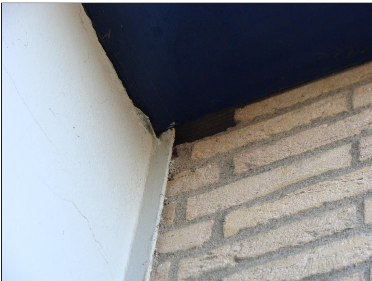
Figuur 15. Ontbrekende baksteen in de gevelmuur naast de toegang tot de elektraruimte, waardoor vleermuizen vrije toegang hebben tot de afgesloten zolder van het noordelijke blok van het MFA.
