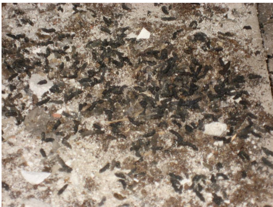
Foto 3 en 4. De uitwerpselen van vleermuizen aangetroffen op de zolder van de kerk (foto: A&W)
