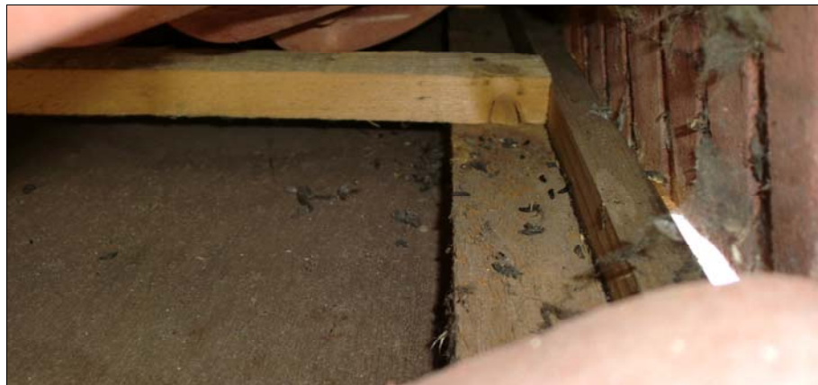
Afbeelding 4. Vleermuisuitwerpselen onder gevelpannen, op het dakbeschot
