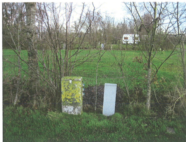
Figuur 5: Terkaple, Waterpark: foto van het zuidoostelijke deel van het plangebied, genomen naar het noordoosten. Op het campingterrein liggen veel leidingen van onder andere water, riolering en elektriciteit, die dwars over de kampeerplaatsen lopen.
