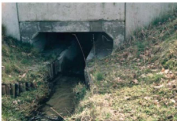
Figuur 8.56 Ecoduiker met aan beide zijden een loopstrook waarin grond is aangebracht.
