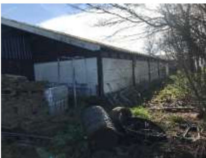
Figuur 17 Schuur met asbestverdacht dak
