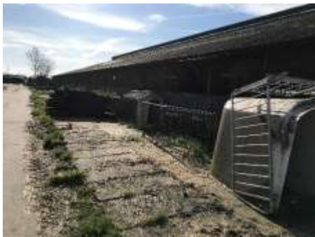
Figuur 21 asbestverdacht dak grote schuur en verharding
