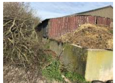
Figuur 23 asbestverdacht dak kleine schuur
