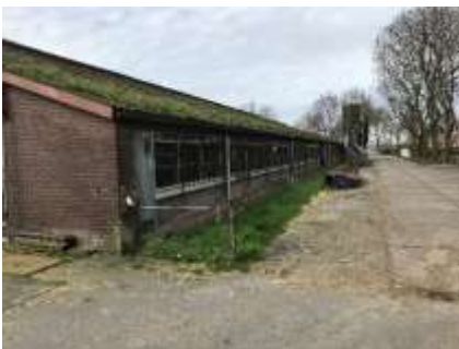
Figuur 25 stal met asbest verdacht dak
