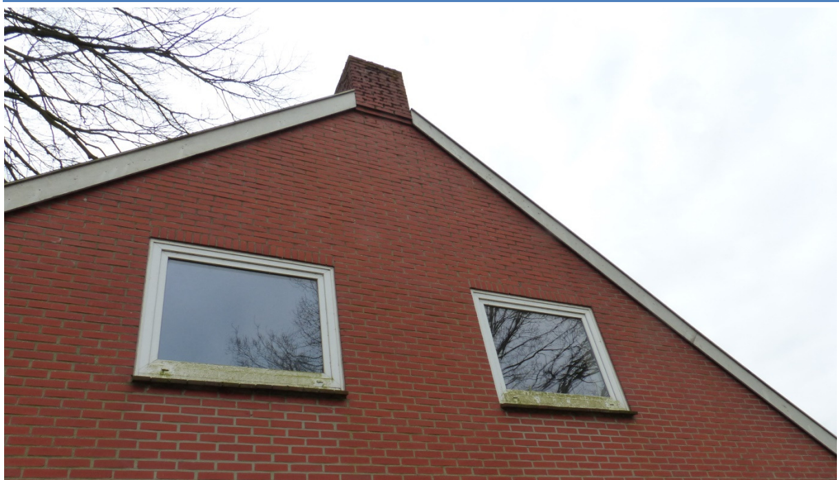
Voorgevel. Nieuwe muur gemetseld tegen oude muur. Geen spouw aanwezig.
