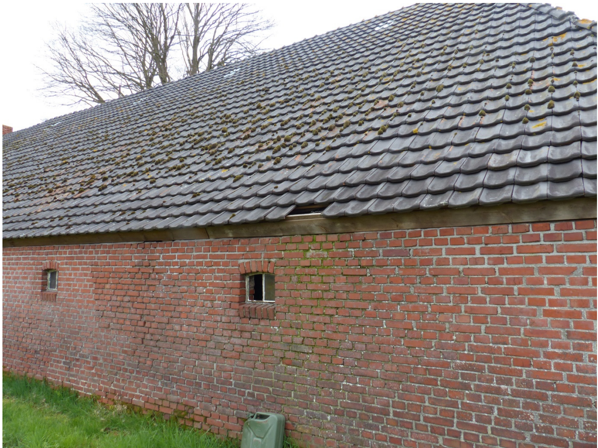
Op sommige plaatsen losliggende en verdwenen dakpannen. Kapotte ruitjes. Goede plaatsen voor dieren om binnen te komen.
