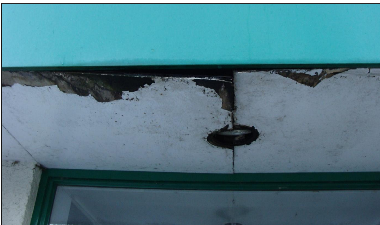
Figuur 11. Houten beplating aan de voorzijde van de winkelruimte, die lokaal los is gekomen en voor steenmarter toegang zou kunnen verschaffen tot de ruimte die erboven aanwezig is.
