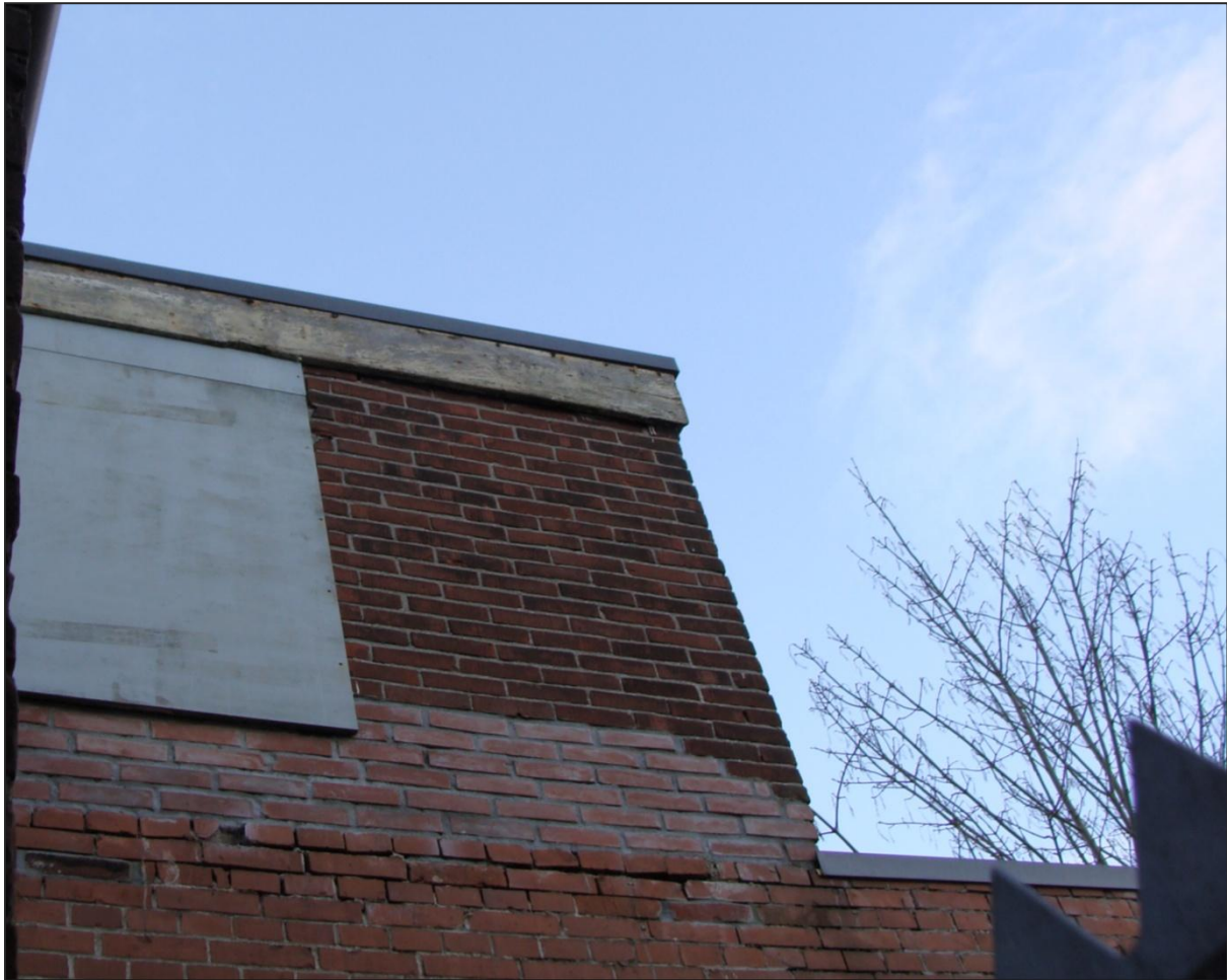
Figuur 8. Aan de achterzijde van de winkelruimte is ruimte aanwezig tussen de muur en de houten daklijst.
