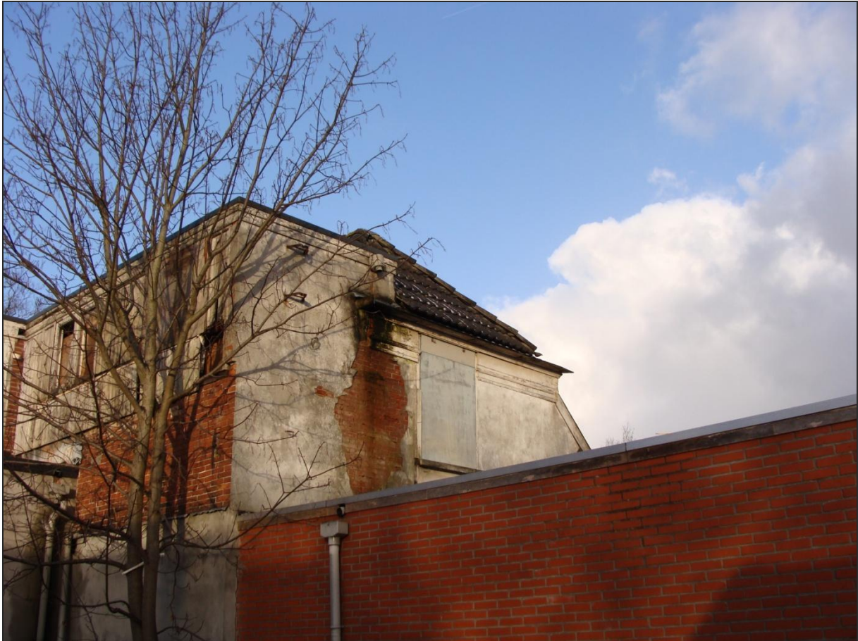
Figuur 9. Aan de achterzijde van de winkelruimte is het nodige verval opgetreden, waardoor in ieder geval het dak en mogelijk ook de muurconstructie toegankelijk is voor vleermuizen.
