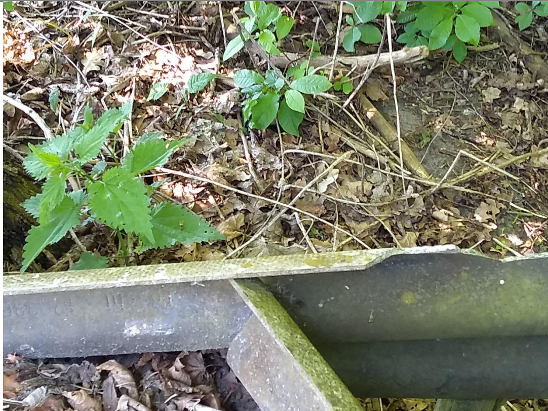
Foto 13: detailfoto van asbestverdacht plaatmateriaal uit foto 12
