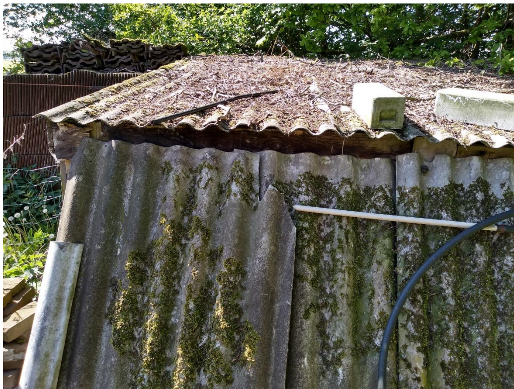
Foto 8: asbestverdachte golfplaten als dakbedekking op het schuurtje en ertegen aan gezet
