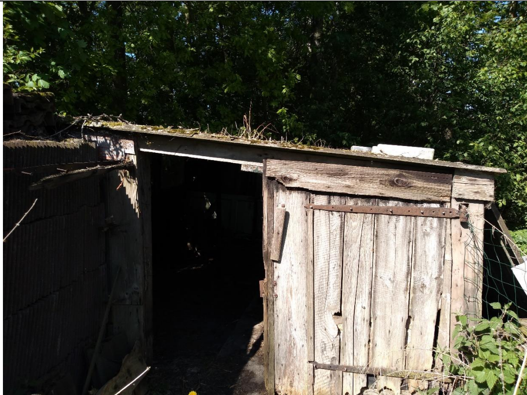
Foto 15: schuurtje naast het schuurtje uit foto's 8 en 9 met asbestverdachte dakbedekking
