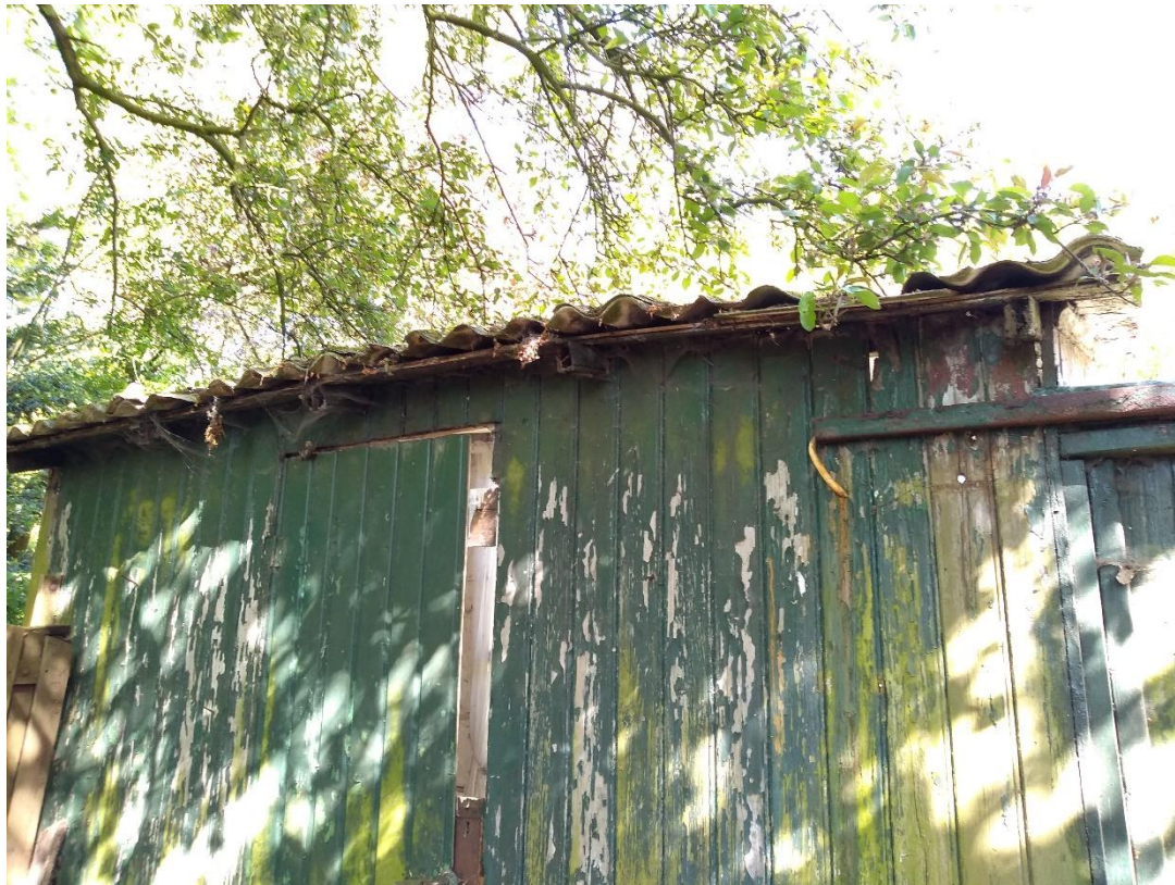
Foto 16: schuurtje op noordwestelijk locatiedeel met wederom asbestverdachte dakbedekking
