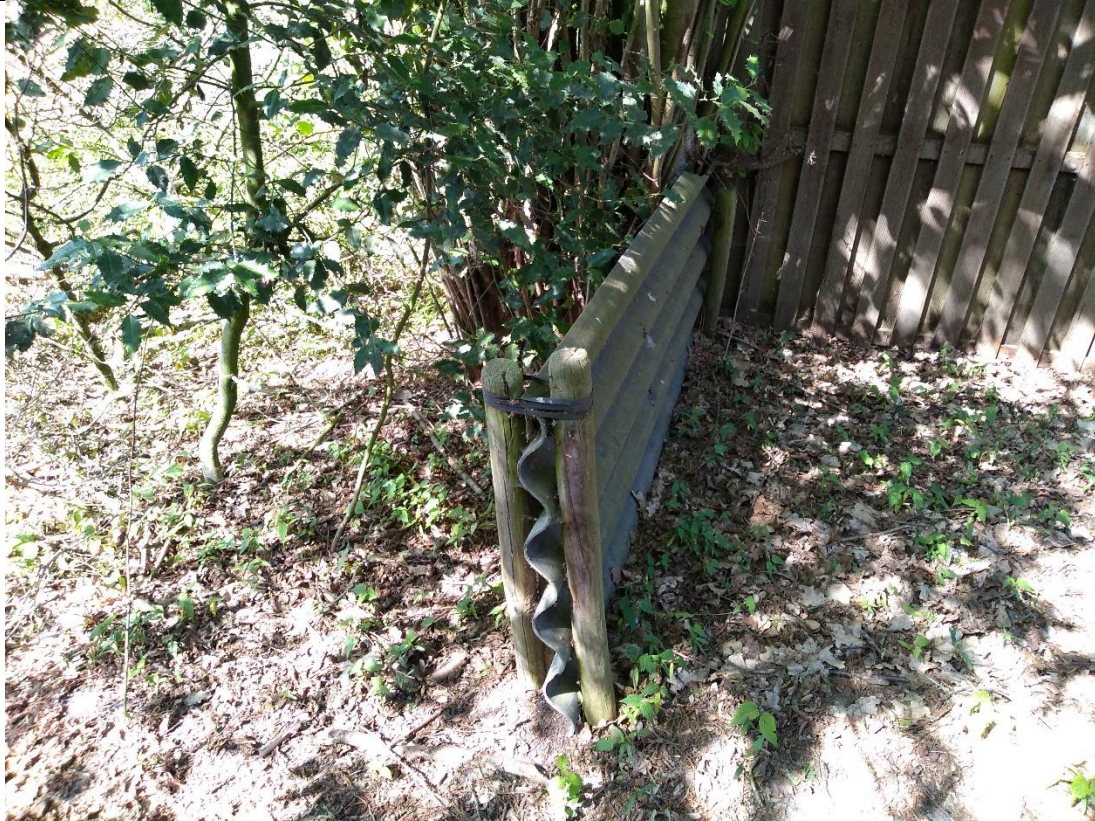
Foto 17: hekwerk met asbestverdacht plaatmateriaal op noordwestelijk locatiedeel
