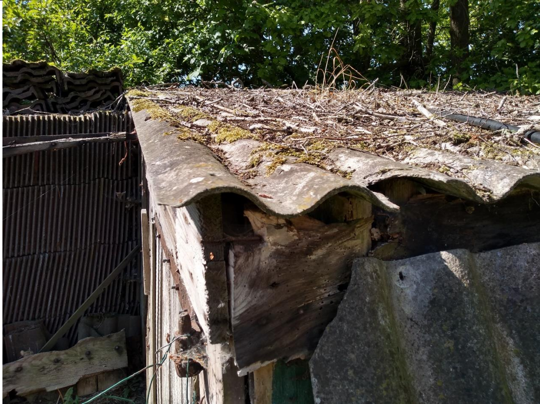
Foto 9: detailfoto van asbestverdacht plaatmateriaal uit foto 8
