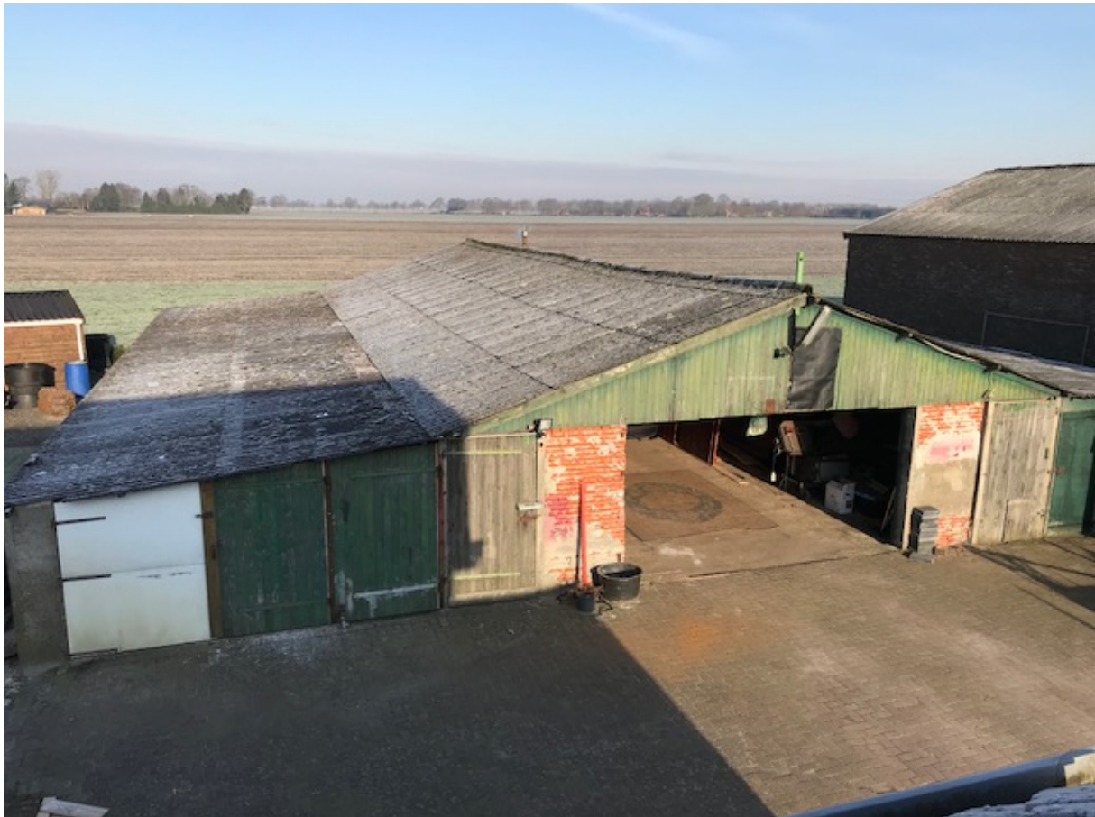
Figuur 2: voormalige schuur met asbestdakbedekking.
