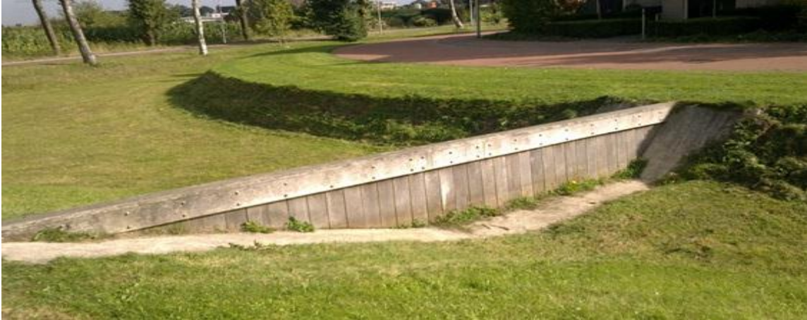
Foto 2 Voorbeeld van een overloopconstructie in een wadi (houten damwand)
