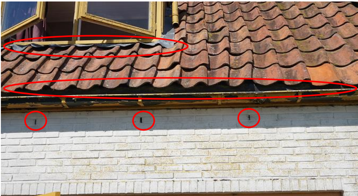
Figuur 5.4. Voorbeelden van potentiële toegangswegen in de vorm van ruimte onder loodslabben en dakpannen, en open stootvoegen (zuidzijde woning).
