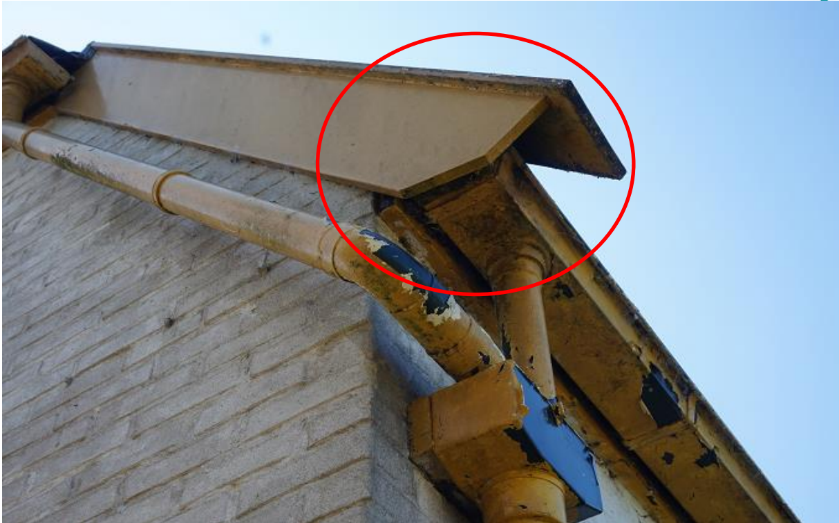
Figuur 5.3. Voorbeeld van potentiële toegangsweg voor vleermuizen onder en achter de windveer van de dakrand (noordzijde woning).
