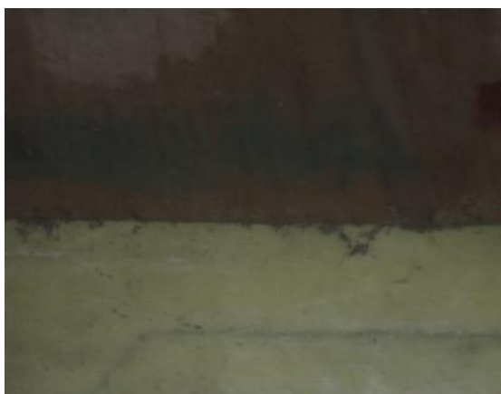
Vochtplekken in het dakbeschot aan de onderzijde van het dak
