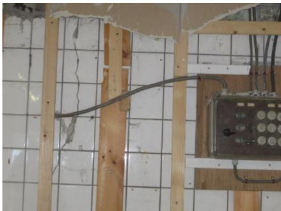
In melklokaal scheuren in de wand.
