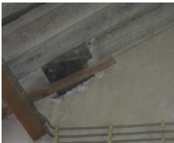
Asbest golfplaten als dakbedekking en stroomkabels in het zicht op de wand en gording aangebracht.
