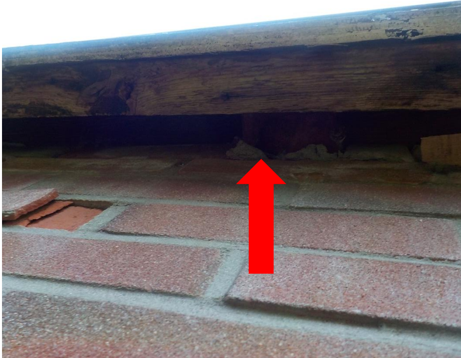
Foto 8 Ruimte tussen gevel en dakgoot (rode pijl) waardoor een vleermuis toegang heeft tot de spouw.
