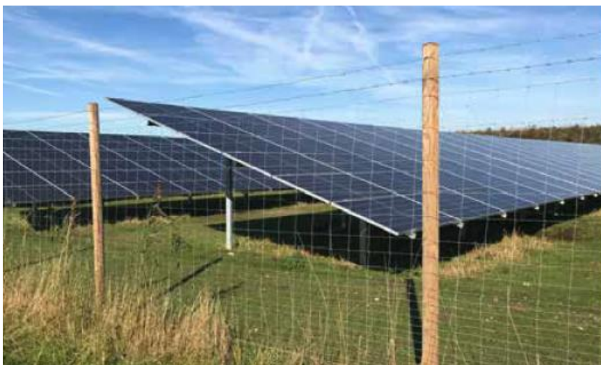
Figuur 2.6, Houten hekwerk ('deer fence') om en zijaanzicht van een zonnepark
