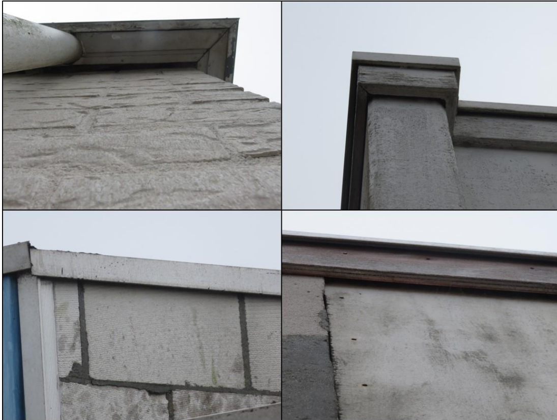
Figuur 2.4. In het gebouw van de autogarage zijn kieren en gaten aanwezig die mogelijk ingangen vormen naar verblijfplaatsen van vleermuizen.
