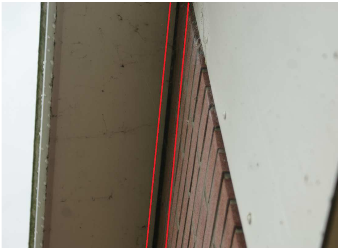
Foto 11 Ruimte tussen dakafwerking en muur, mogelijke toegang tot spouwmuur
