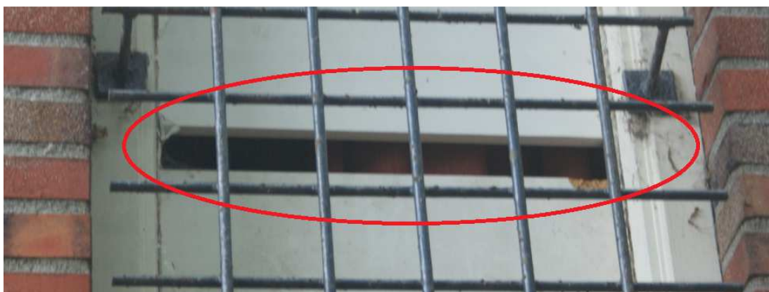
Foto 12 Invliegopening bij ventilatieopeningen
