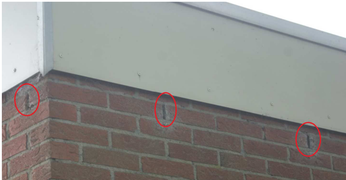
Figuur 5.4 Openstootvoegen clubgebouw Willem de Merodelaan 2
