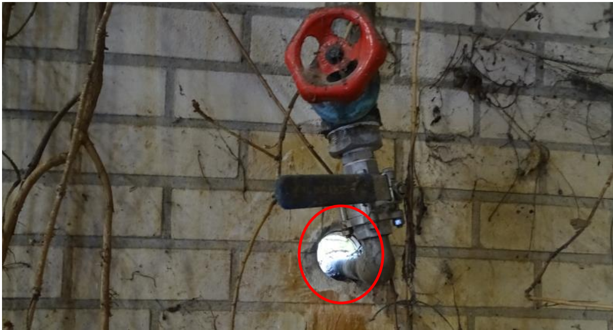
Figuur 5.4. Toegangsmogelijkheid voor de steenmarter om de loods in te komen, gat in de muur (rood omrand).
