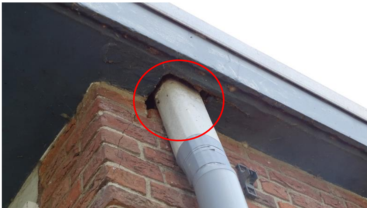
Figuur 5.10. Opening rondom de regenpijp (rood omcirkeld) aan de noordwestzijde van het gebouw.
