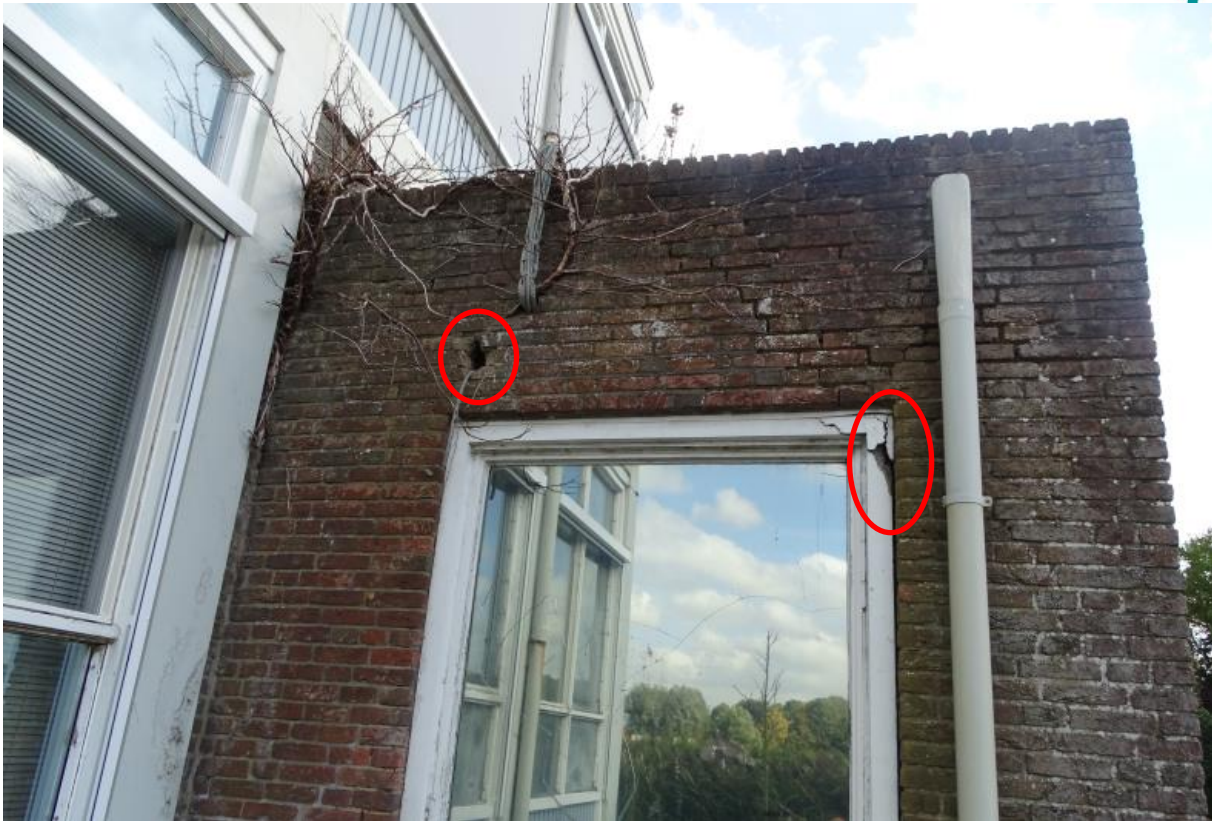
Figuur 5.11. Verschillende gaten in de muur (rood omcirkeld) aan de zuidwestzijde van het gebouw.
