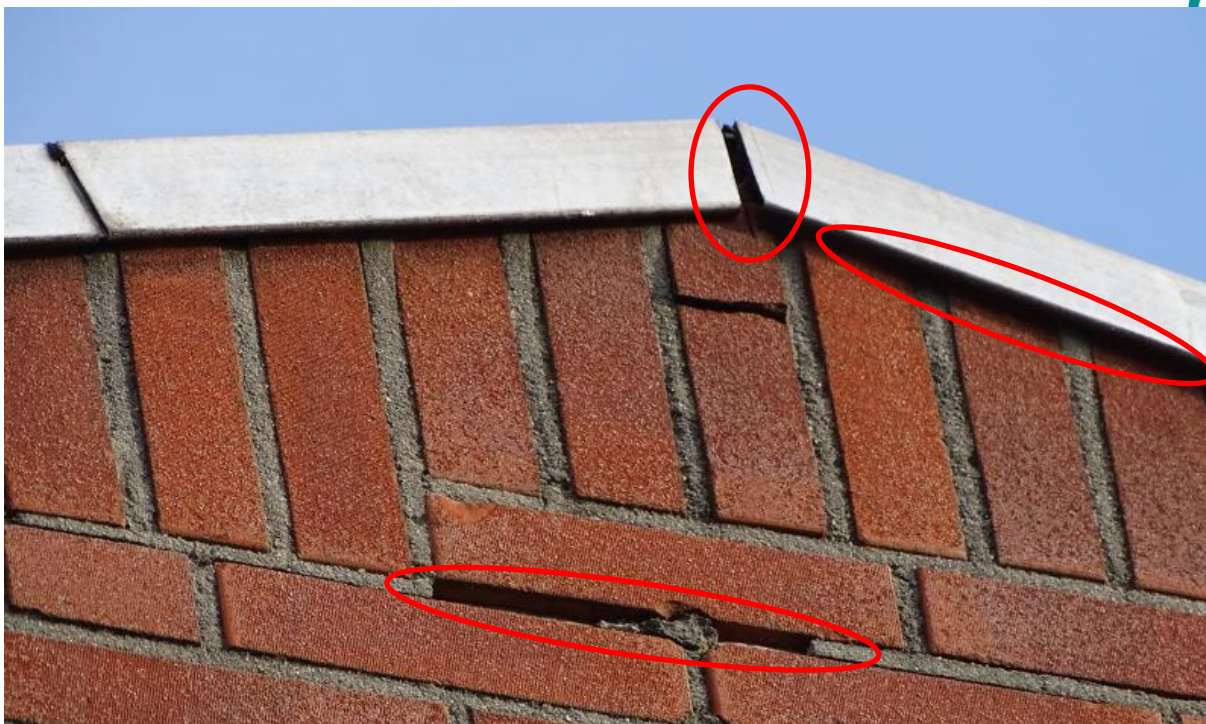
Figuur 5.8. Ruimte onder dakrand en voegen die missen, toegangsmogelijkheden naar potentiële verblijfplaatsen.
