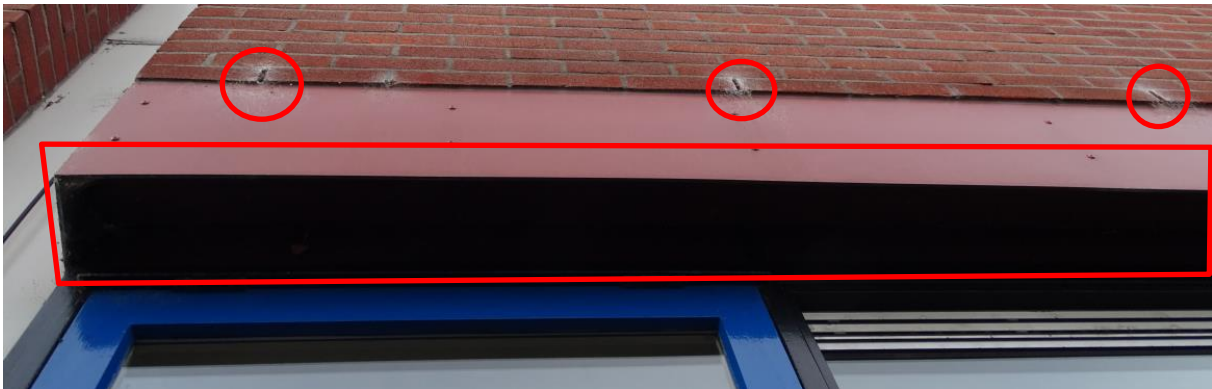
Figuur 5.4. Open stootvoegen en ruimte onder rode houten gevel betimmering, toegangsmogelijkheden naar potentiële verblijfplaats vleermuizen.
