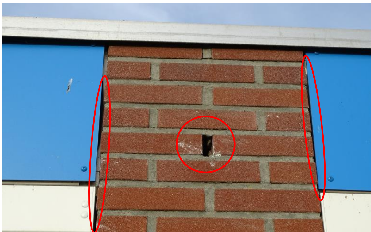
Figuur 5.7. Open stootvoeg en ruimte tussen muur en gevelbetimmering, toegangsmogelijkheden naar potentiële verblijfplaatsen.
