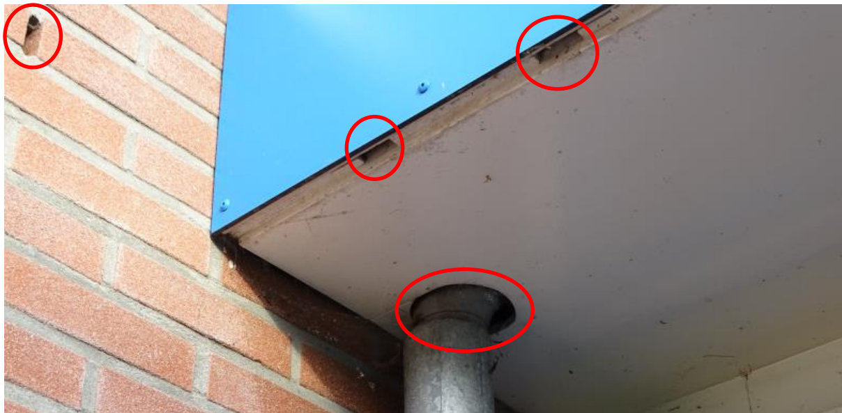
Figuur 5.6. Open stootvoeg, ruimte onder gevelbetimmering en ruimte bij de regenpijp vormen toegangsmogelijkheden naar potentiële verblijfplaatsen.
