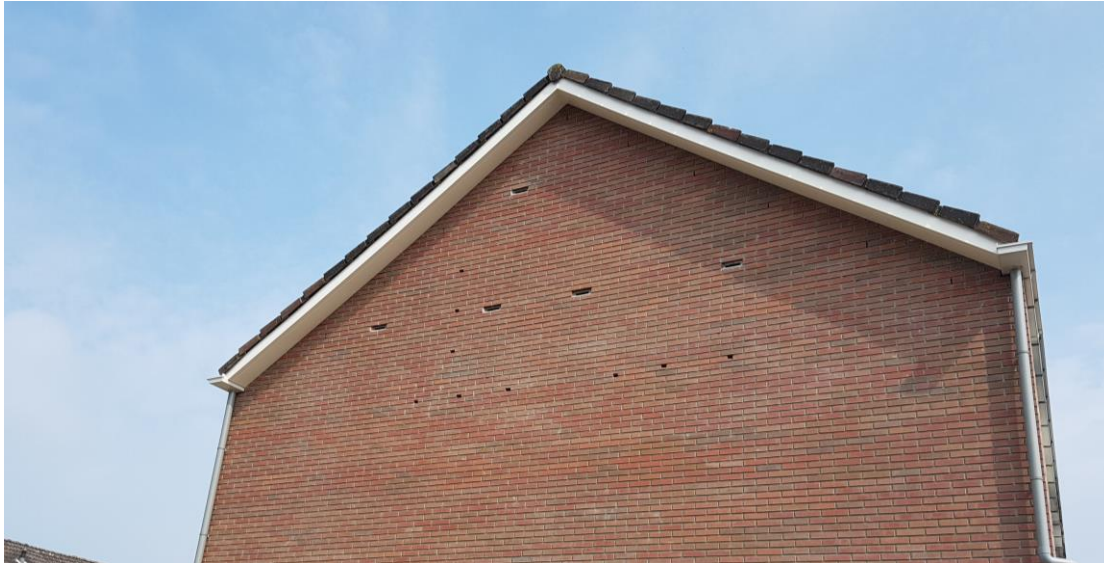
Figuur 2-5 Verstevigde hoekwoning aan de Burg. De Sitterstraat met (inmetsel)voorziening voor vleermuizen en gierzwaluwen.
