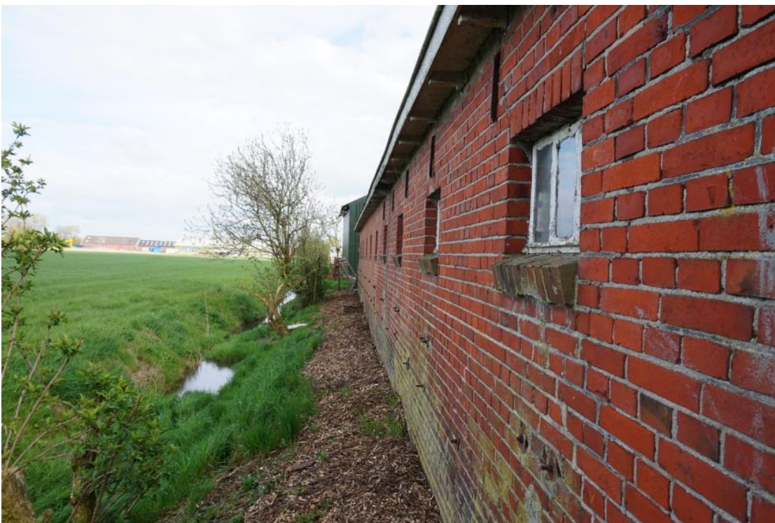
Figuur 2 Noodzijde van onderzochte woning met naastgelegen sloot.
