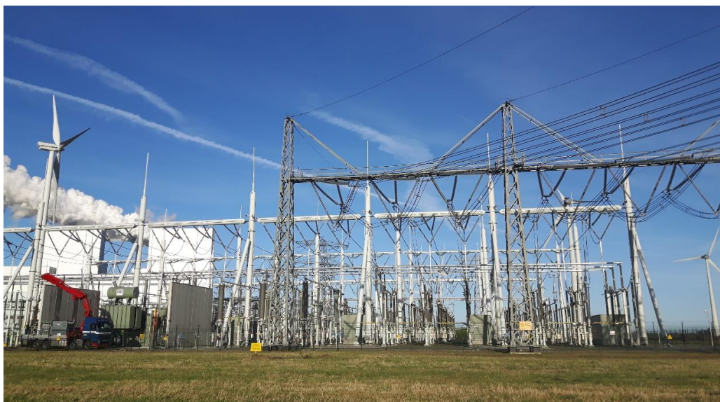
Foto 2: Hoogspanningsstation Eemshaven Oudeschip
