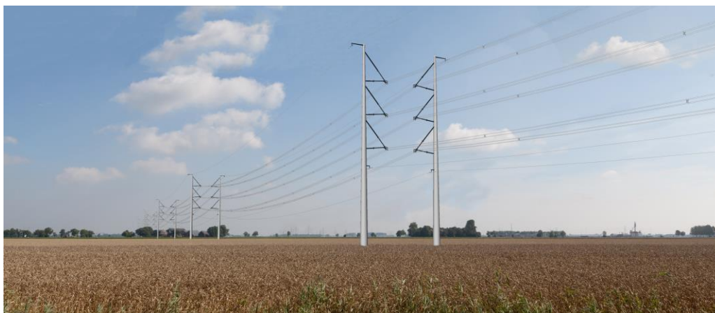
Foto 3: Wintrackmast met 2 circuits 380 kV
