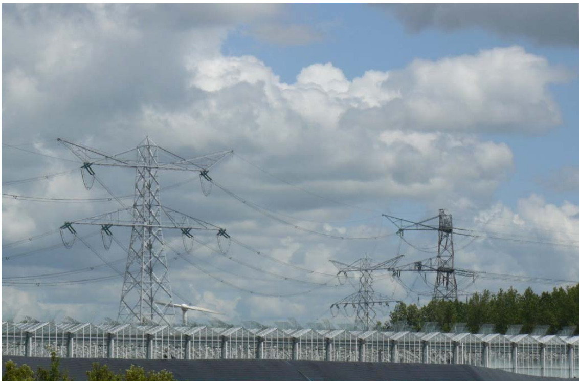
Foto 8 380kV-verbinding in het glastuinbouwgebied bij Rilland, met de 380kV-aantakking richting Zandvliet in België.
