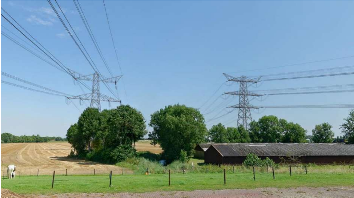
Afbeelding 5b Foto montage met Moldau combi hoekmast (rechts) bundelt met de bestaande 380kV lijn Geertruidenberg-Rilland (links, hoekmast).
