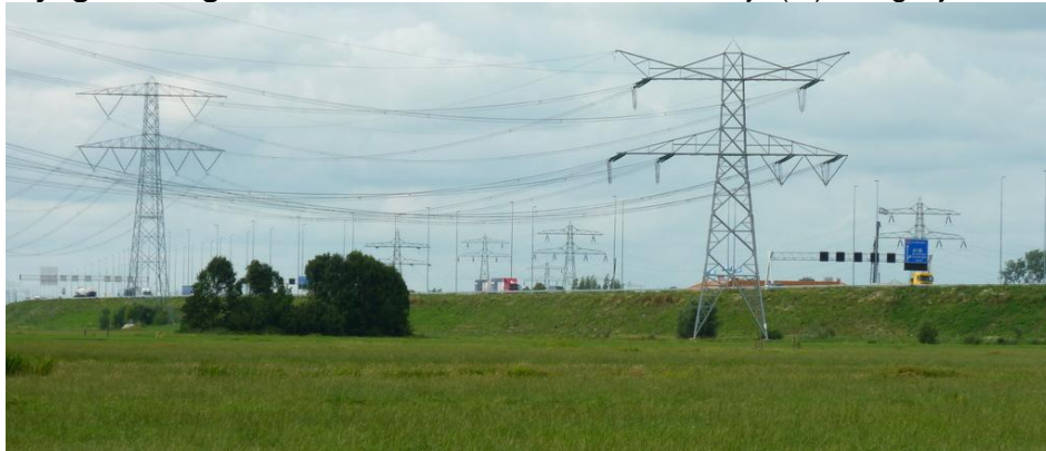
B2.7a. De knik in de 380 kV-verbinding Krimpen-Diemen, gezien uit het zuiden, over de mogelijke stationslocatie. Aan deze zijde van de A2 de masen 106 en 105. Aan de andere zijde van de A2 het niet verzwaarde deel van de 150 kV-verbinding Lage Weide-Breukelen.
