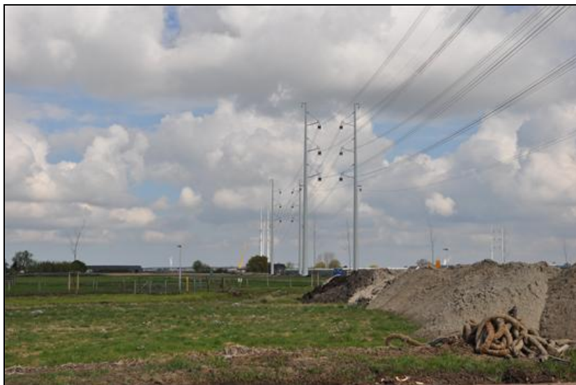
Figuur 1: 380 kV hoogspanningsleiding (bron: www.zuidwest380kvcreatesend.com ).
