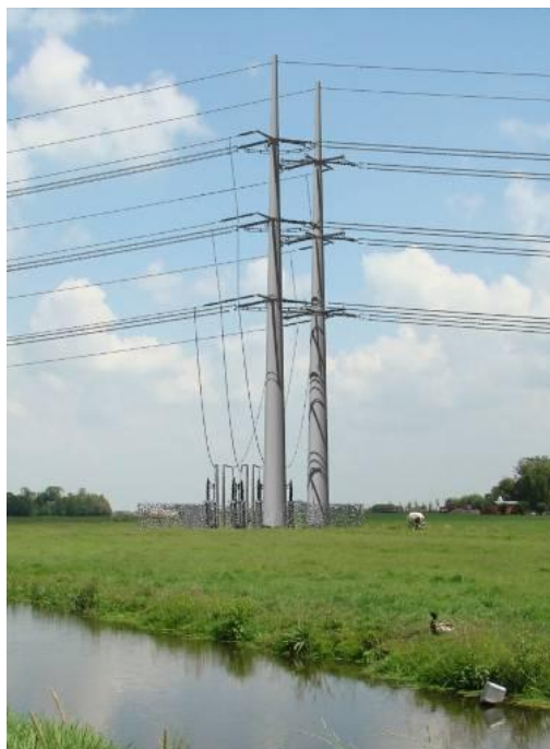
Foto 21: Impressie opstijgpunt 150 kV bij een Wintrackmast
