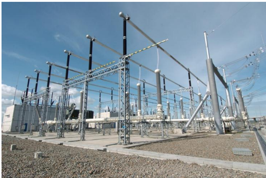
Foto 17: Impressie van een veld met schakelapparatuur
