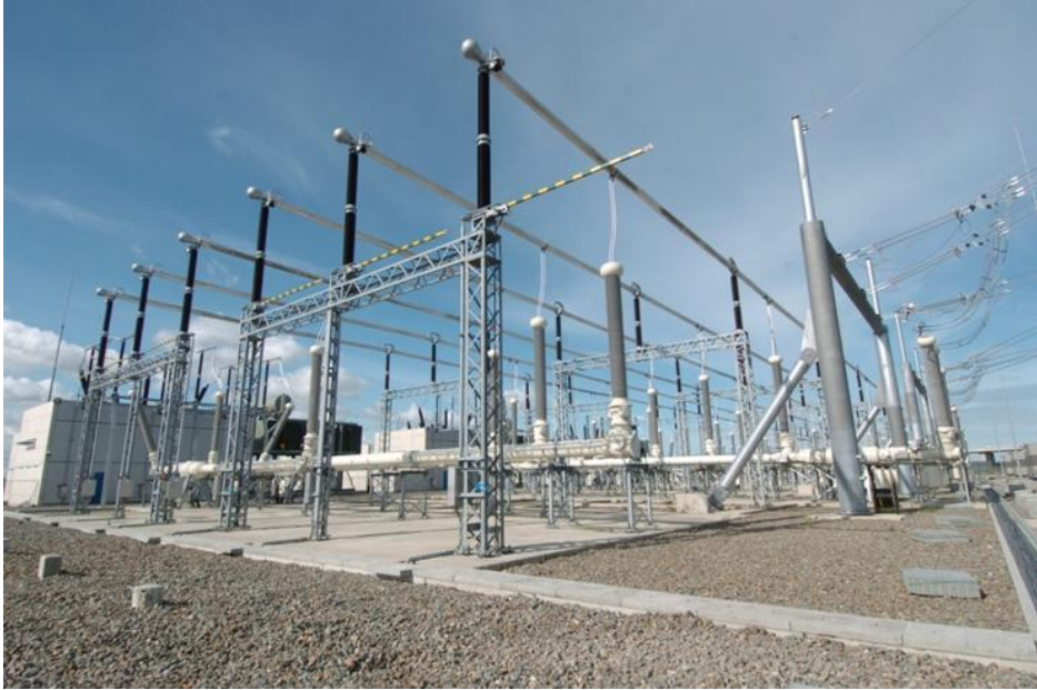
Foto 1 Foto van een veld met schakelapparatuur.
