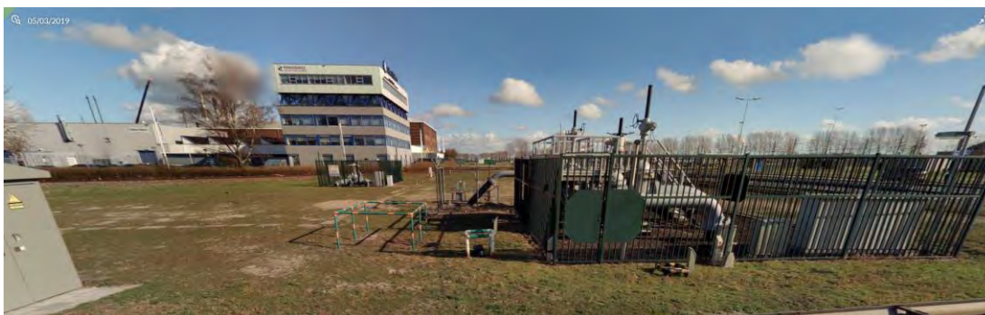
Figuur 10.2 Typisch beeld van de leidingstrook (hier de Welplaatweg) met pompinstallaties en kale stukken grond (Cyclomedia)
