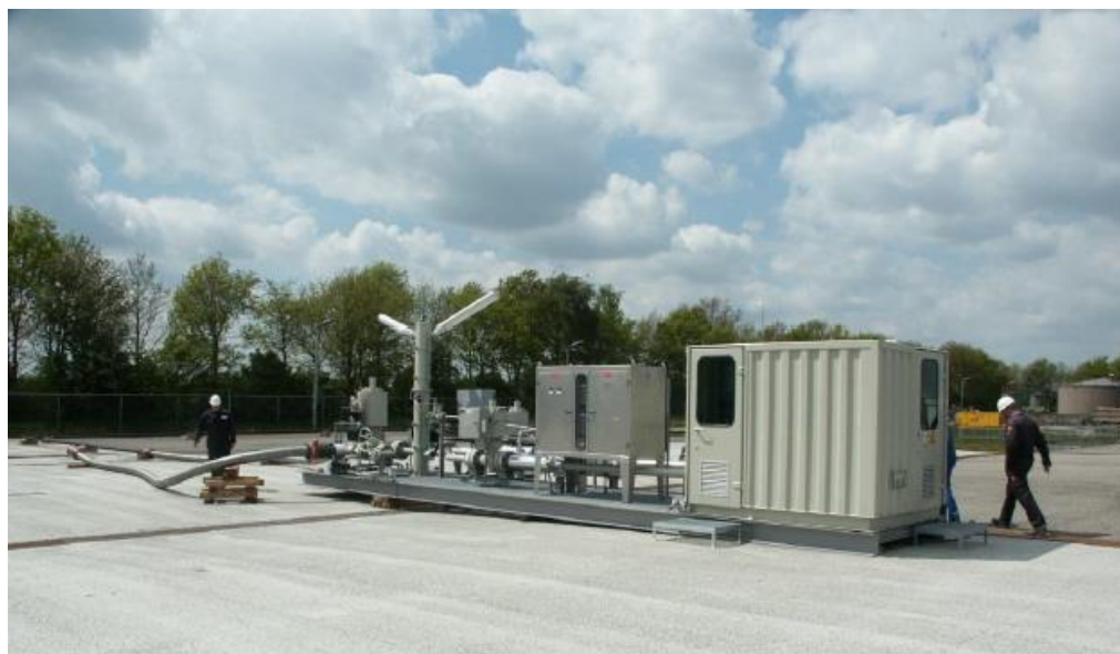
Figuur 2.3 Voorbeeld van een productie-eenheid op een productielocatie (bron: MER Gasboring en gaswinning Ternaard)
