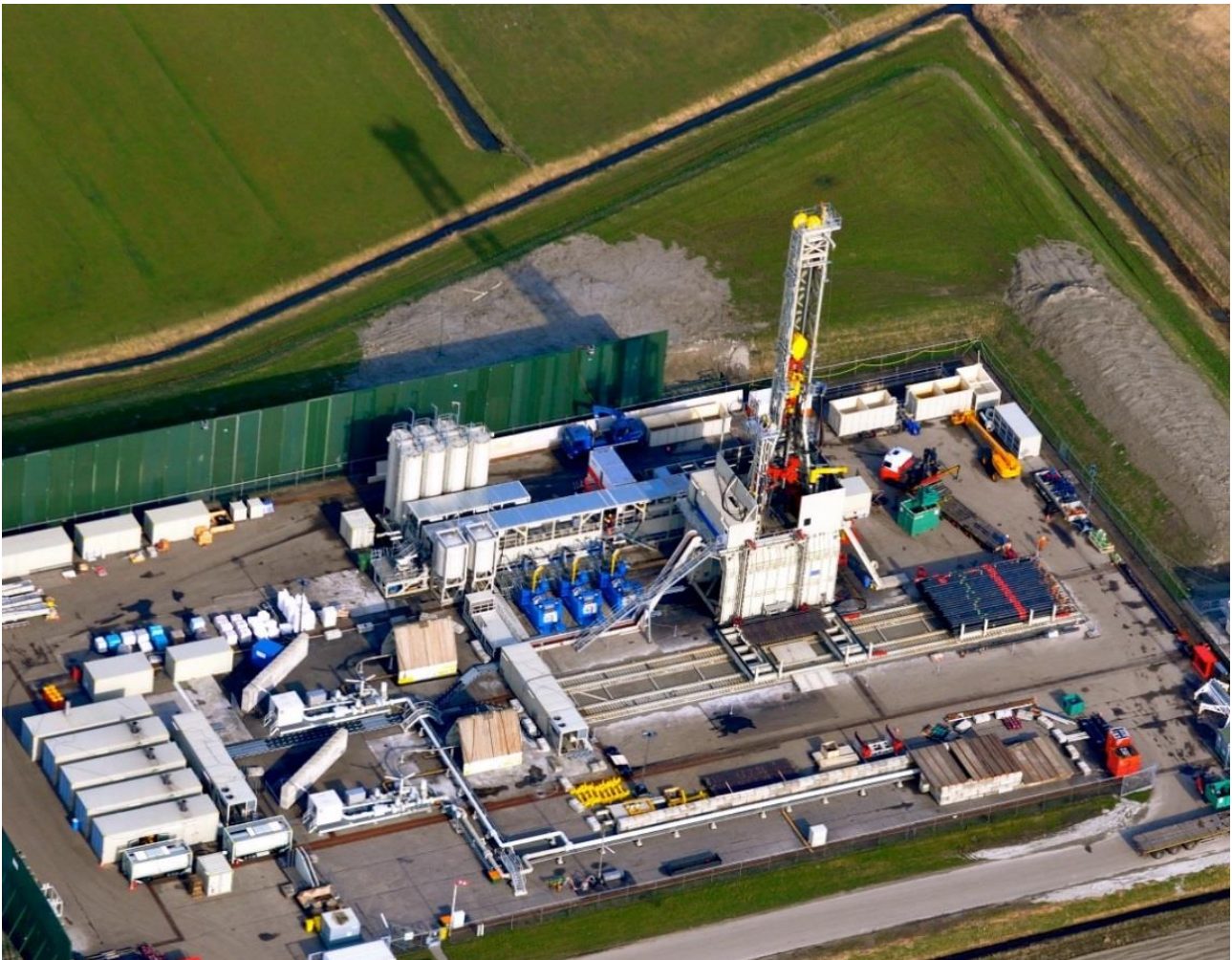
Figuur 3-1 Boorinstallatie inclusief boortoren en geluidswanden. Deze installatie staat meestal enkele maanden op locatie.
