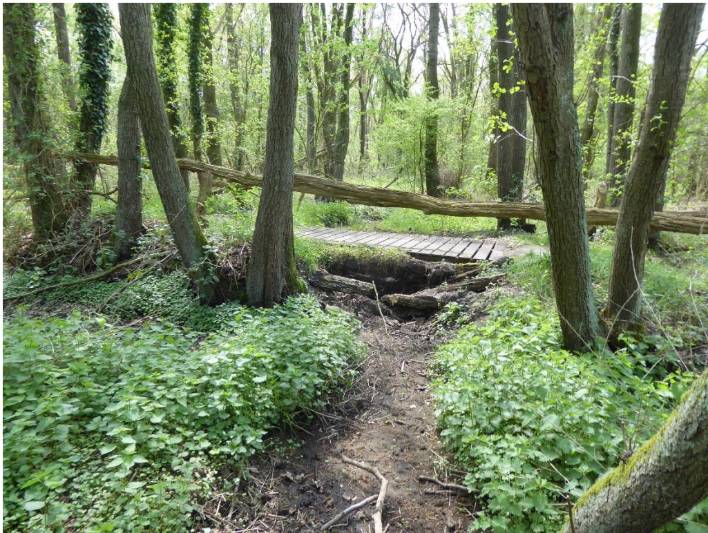
Foto 8 Dikke takken in de beekloop (ter plaatse van bruggetje bij B15) die bij hoge afvoeren opstuwing veroorzaken, als gevolg waarvan het beekdalgedeelte bovenstrooms hiervan relatief vaak overstroomt (datum foto: 24-4-2019).
