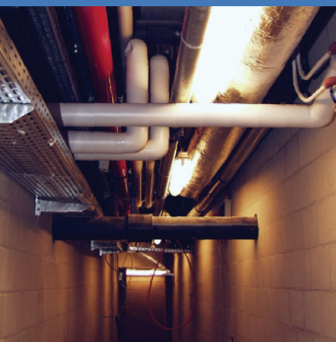
Doorvoeringen bedreigen de compartimentering; de vele technische installaties, leidingen, buizen en kabelgoten
