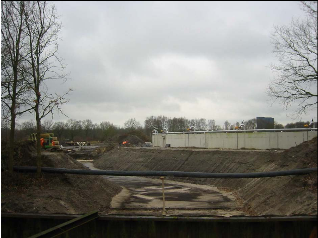
Fig. 38: De Waterzuivering Oost. Op de foto (opname H. van Dijk, januari 2005) is het ingrijpende grondverzet zichtbaar dat momenteel pal ten westen van de Moerenburgseweg wordt uitgevoerd. Waarschijnlijk maken deze werkzaamheden deel uit van de aanleg van het helofytenfilter.
