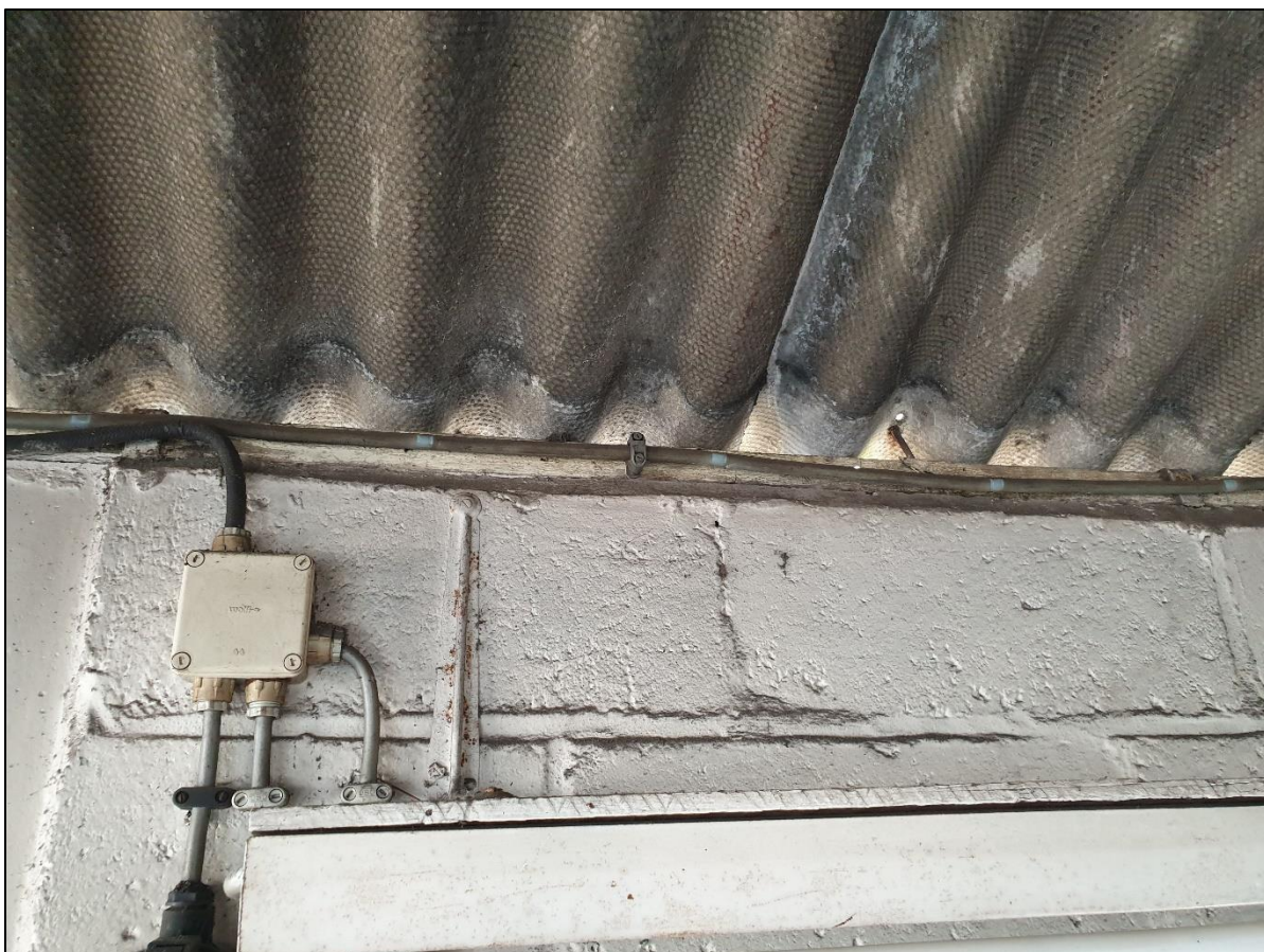
Foto 5. Detail binnenkant garage, directe opening naar buiten tussen asbestplaten en buitenmuur.
