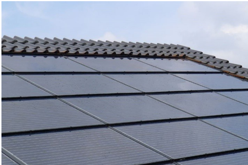
Daken met geïntegreerde zonnepanelen
