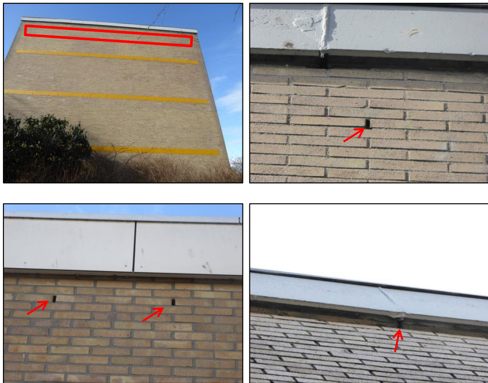
Open stootvoegen en ruimtes onder de dakrand. Het rode kader illustreert de globale hoogte waarop de open stootvoegen zijn aangetroffen. De rode pijlen illustreren de open stootvoegen en ruimtes onder de dakrand.
