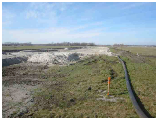
Werkzaamheden ten behoeve van de aanleg van een gasleiding, net buiten het plangebied.
