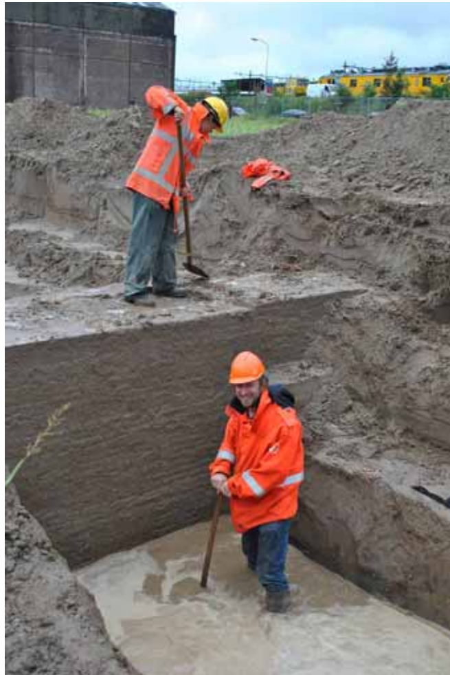
5. Vrijleggen van het muurwerk van de westelijke lunet van de Linie van Van Coehoorn.
