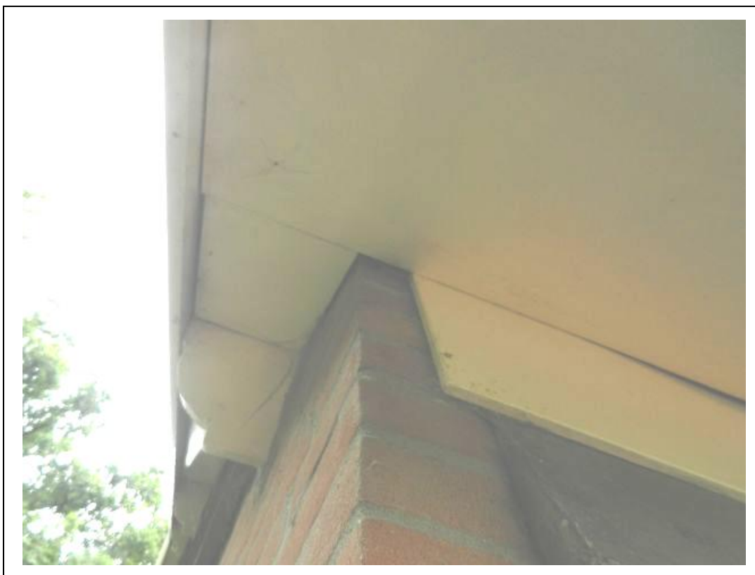
Foto 2. Spleten en kieren rond de door te breken muur.
